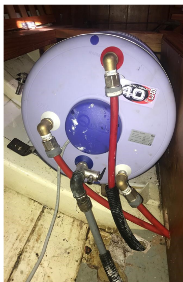
Un nouveau chauffe-eau
